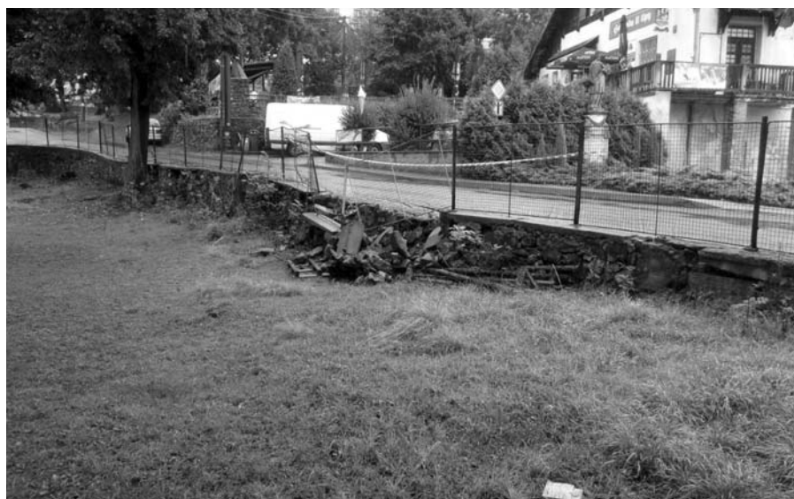
Silnice, která se propadla v místech naproti vjezdu do dvora, je ešena jejím správcem - tedy Krajskou správou a údržbou silnic Karlovarského kraje spolu se sou asným majitelem zámku panem Karlem Eugenem Czerninem.
